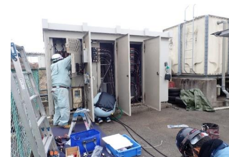
高圧受電設備の対応も可能です
